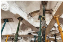
La bóveda se encuentra apuntalada para evitar su desprendimiento.
